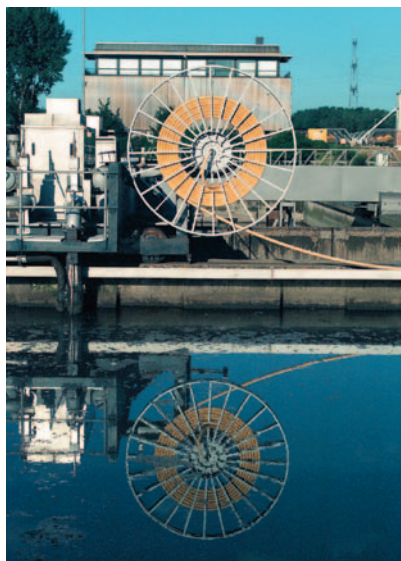
Vyčištěno! Motorový kabelový bubek Sprinter zabezpečující přenos energie a dat na most čistírny odpadních vod.
