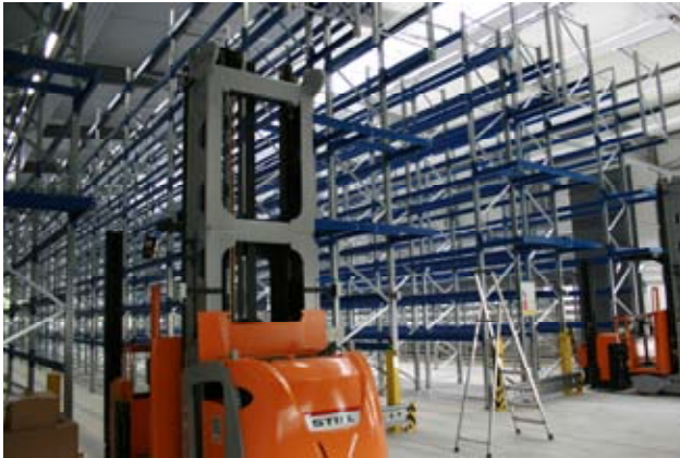
Lagergassen mit induktiv geführten Bediengeräten
